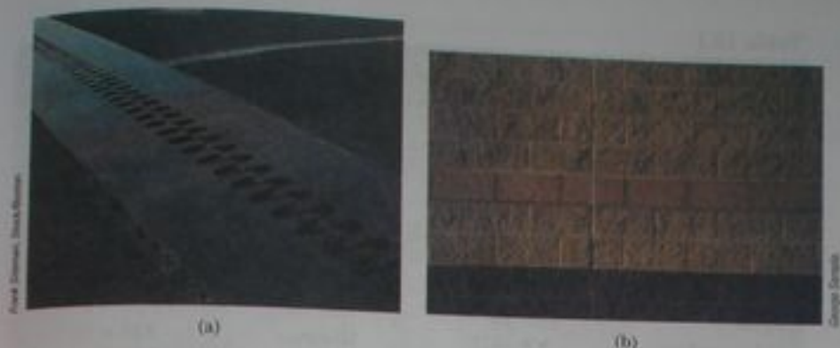
Figura 19.7 (a) Se usan juntas de expansión térmica para separar secciones de pavimento en puentes. Sin estas juntas, las superficies se pandearían debido a la expansión térmica en días muy calurosos, o se agrietarían debido a la contracción en días muy fríos. (b) La junta vertical larga se llena con material suave que permite que la pared se expanda y se contraiga cuando cambia la temperatura de los ladrillos.
